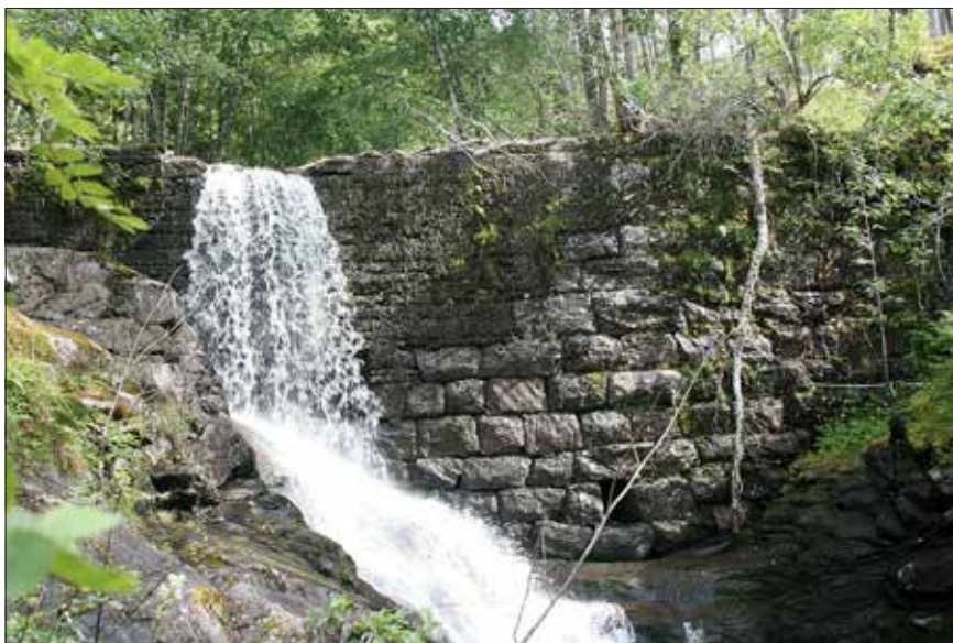
Nedre sperredam 2013. Det er ikkje vanskeleg å sjå skilnad på det som vart mura opp i 1890-åra, og reparasjonen frå 1933. Dammen er full med skredmasse så vatnet renn over dammen i dag. (Foto Knut Sæther)
