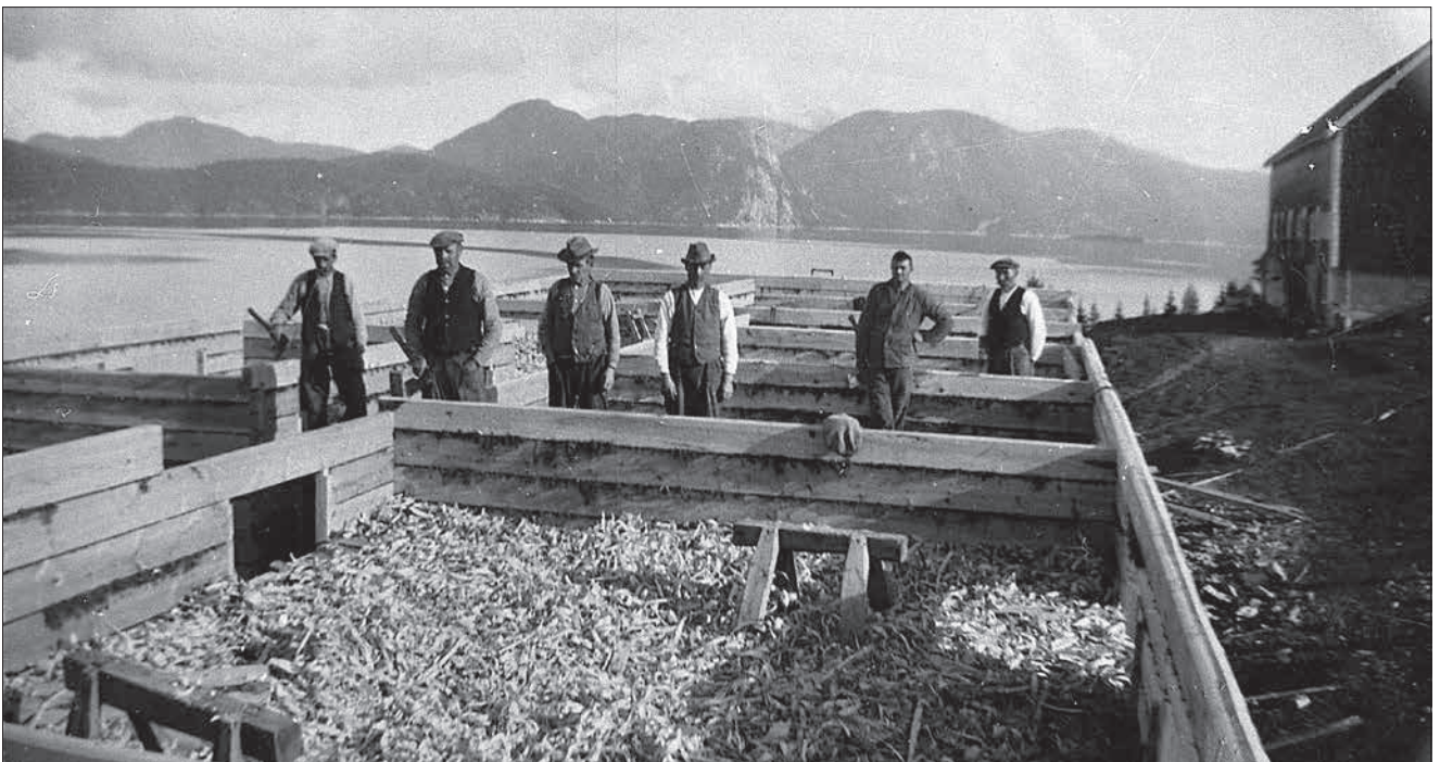
Frå bygginga av Nilsens Pensjonat på Eidsøra ca. 1934. Karane er frå venstre Kristian Lyster, Oluf Rød, Johan Hanseth, Kristian Åfløydal, Ole Mittet, Simon Lange. Alt tømmeret vart høvla med okshøvel, og det næraste rommet er fullt av høvelfløy (-spon). (Foto Romsdalsmuseet)
