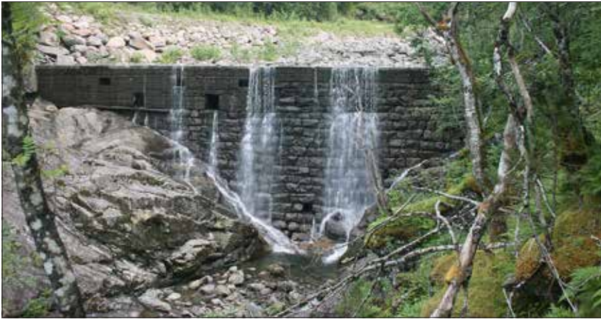
Øvre sperredam 2013. Også denne dammen er reparert etter flaumskade. Bak t.v. går anleggsvegen opp til kraftverksinntaket som vart nybygd for nokre år sidan. (Foto Knut Sæther)
