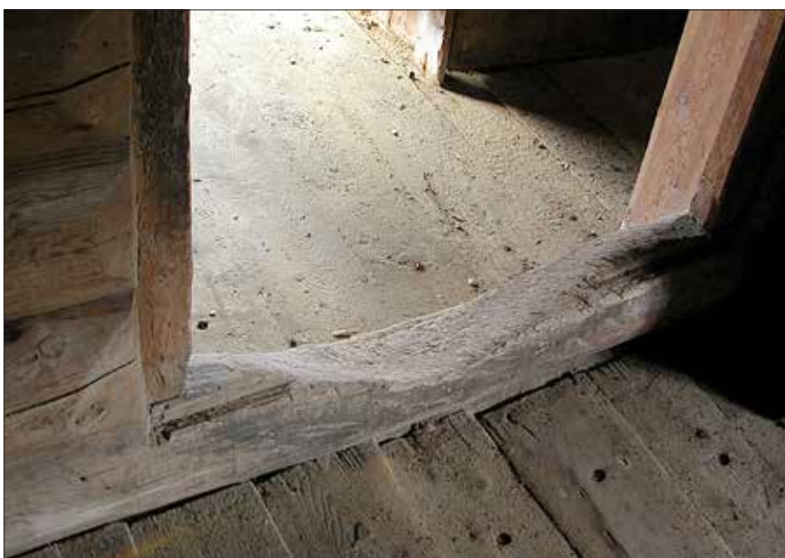
Mykje gammalt saltkjøt er hogd sundt på denne dørstokken i Hammervollstabburet. Merka etter kjøtøksa fortel kulturhistorie. Stabburgolvet innafor er tært av salt og sterk saltlake over lang tid. (Foto Bjørn Austigard/Romsdalsmuseet)
